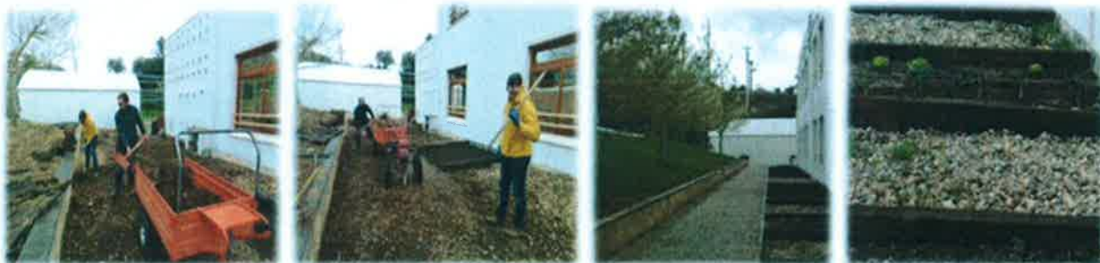
Figuras 206 a 209. Intervenções realizadas no âmbito do projeto Eficiência Hídrica na Escola
